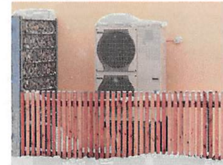
Luft-Wärmepumpe mit Lärmschutz
